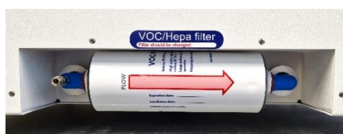
Figura 12.3 Filtro COV/HEPA instalado corretamente
